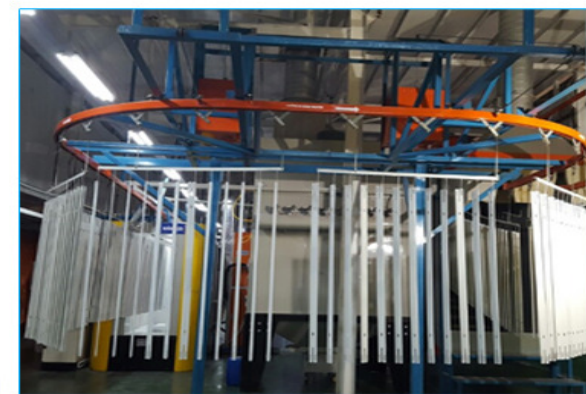
HỆ THỐNG SƠN TĨNH ĐIỆN
